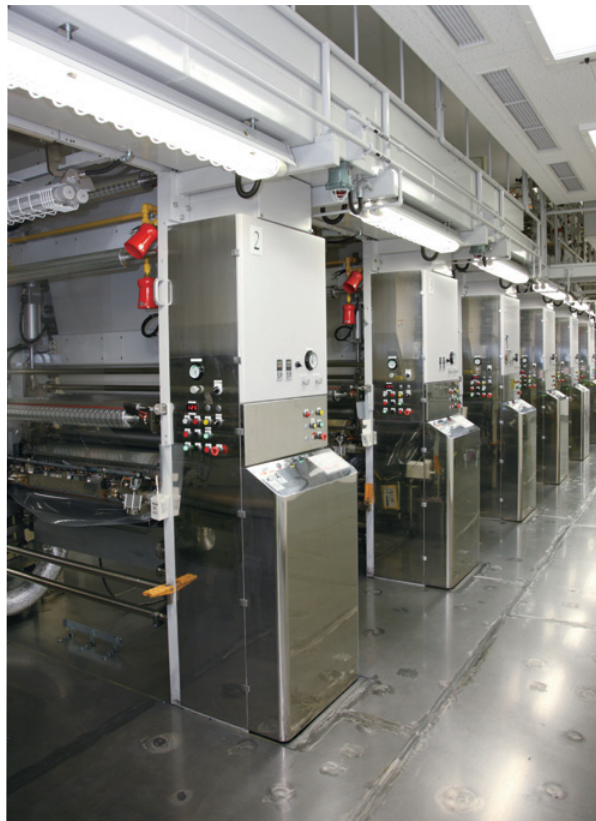
最新鋭の設備を導入した工場の内部
