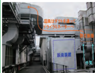
排熱リサイクルシステム
