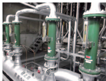
活性炭搬送用配管の点検の強化
