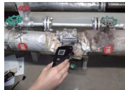
蒸気バルブ・トラップ診断の様子
